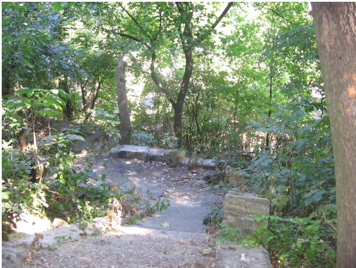
Рис. 7. Разрушенная бетонная лестница склонов
