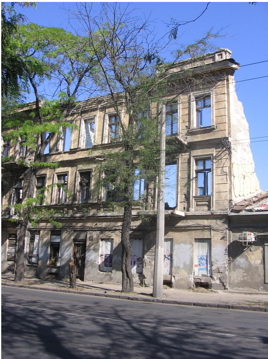
Рис. 10. Аварийный многоквартирный жилой дом, расположенный по ул. Приморская
