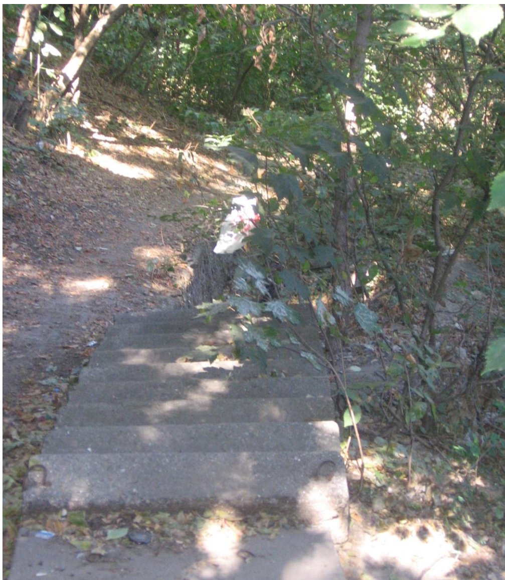
Рис. 9. Разрушенная бетонная лестница склонов
