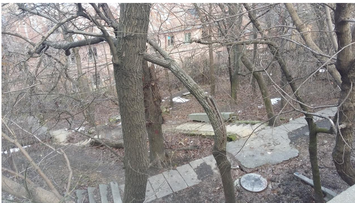
Рис. 8. Разрушенная бетонная лестница склонов
